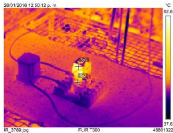
Figura 1. Termografía del relevador marca Square D tipo KPD13.
