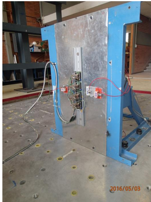
Figura 2. Instalación de los relevadores marca Square D tipo KPD13, para las pruebas OBE y SSE (dirección Lado-Lado/Vertical).
